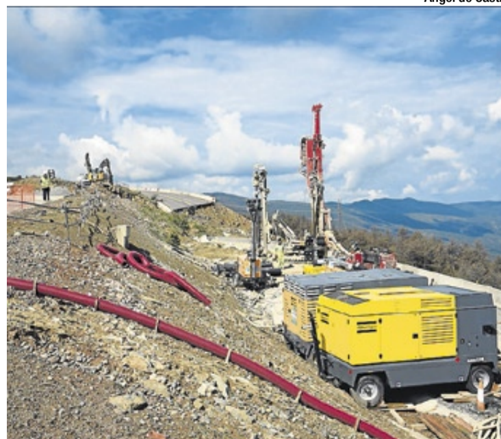
El tramo hundido. Las máquinas arreglan la carretera destruida.
